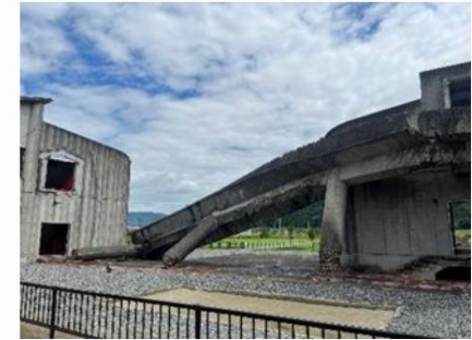
津波の引き潮で倒壊した渡り廊下
